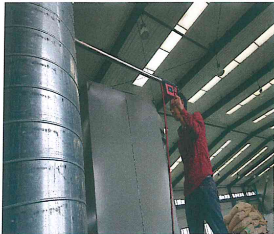
1号光解除尘出口
