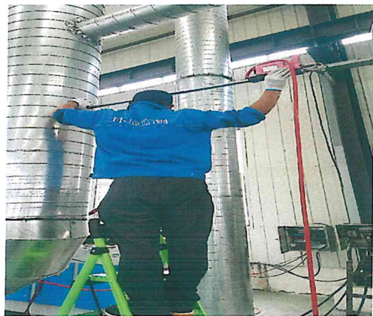
1号光解除尘进口
